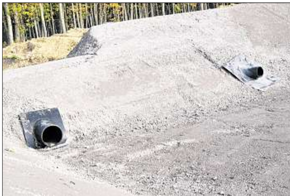
Der Deponiekörper ist mit einem Rohrleitungssystem durchsetzt, das das verschmutzte Regenwasser zur Reinigung leitet.
