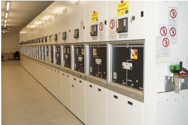
SWI - Innenraum des Schalthauses Kothau
