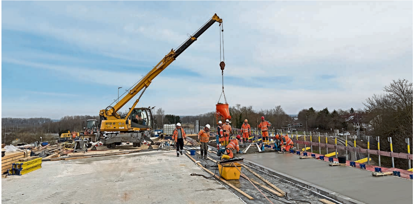
Die Fertigstellung der Brücke über die Bahnanlage ist im Laufe des Monats Mai geplant. Der bisherige Bahnübergang wird beseitigt. Foto: Michel
