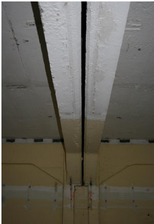
Abbildung 10: Deckenspalt der Gebäudeteilanschlüsse Körnermagazin (Lippl; 11.02.2024)
