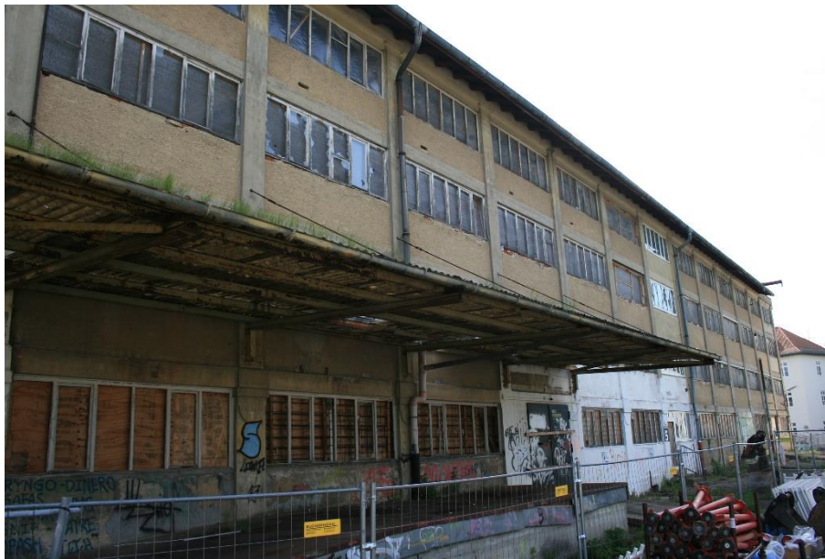
Abbildung 3: Gebäudeabdichtung Körnermagazin Südseite (Lippl; 07.05.2023)
