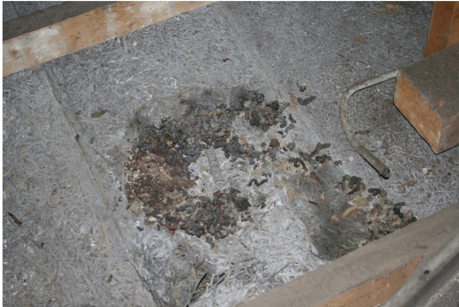
Abbildung 5: Alter Taubenkot im Dachstuhl des Körnermagazins (Lippl; 11.02.2024)
