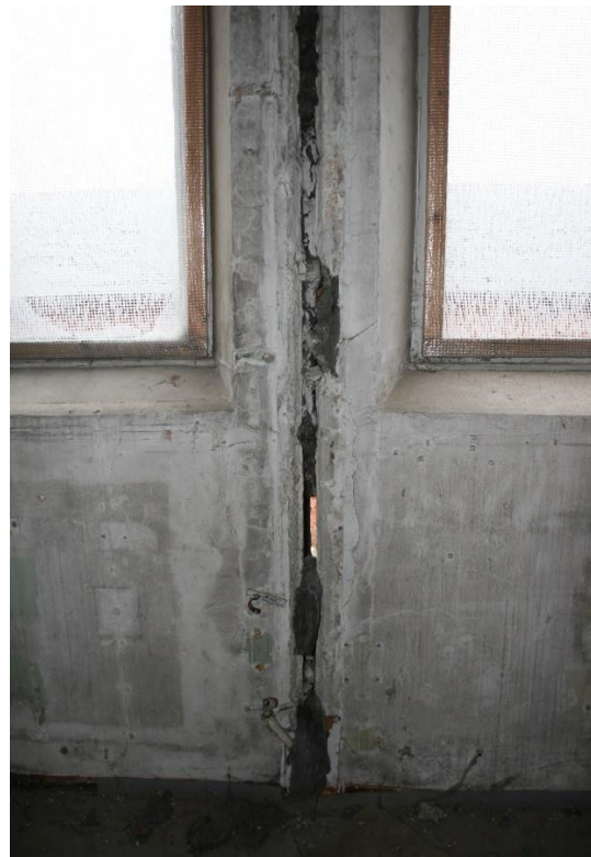
Abbildung 11: Mauerspalt der Gebäudeteilanschlüsse Körnermagazin (Lippl; 11.02.2024)
