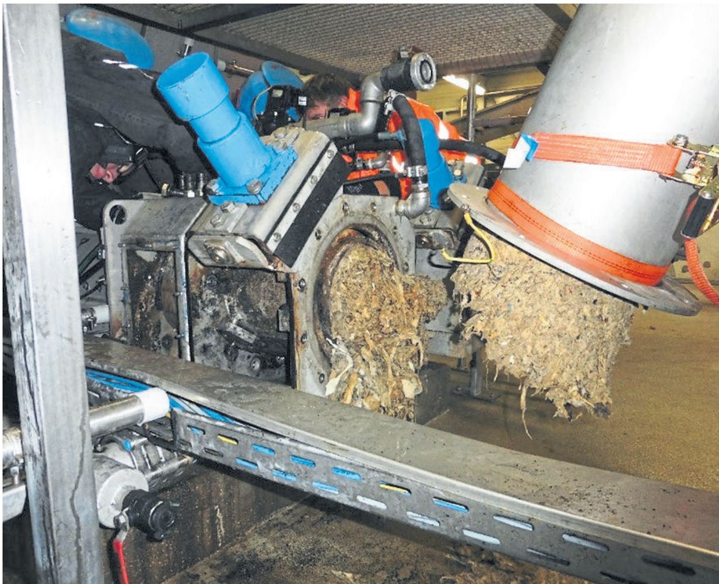
Verzopfungen im Bereich der Rechenanlage der ZKA
